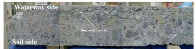
図1 凍害損傷が顕在化した鉄筋コンクリート部材(水利施設)
