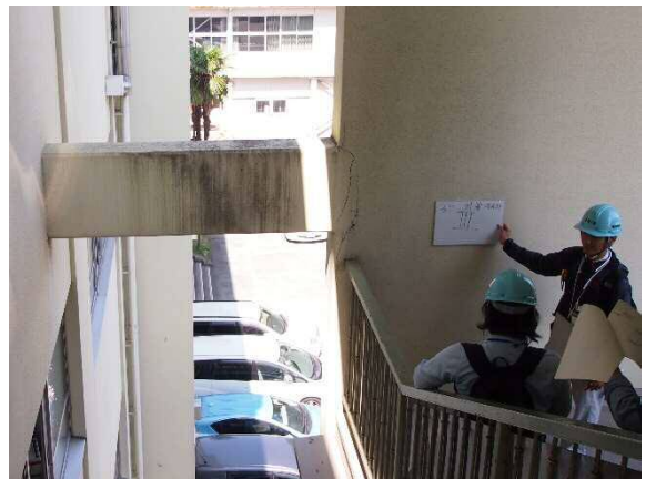
2016年熊本地震の被害調査
